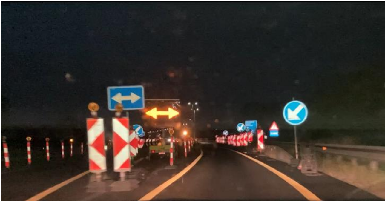
Figuur 23 Voorbeeld aanrijding bakens (verkeersveiligheidsinspectieverslag)
