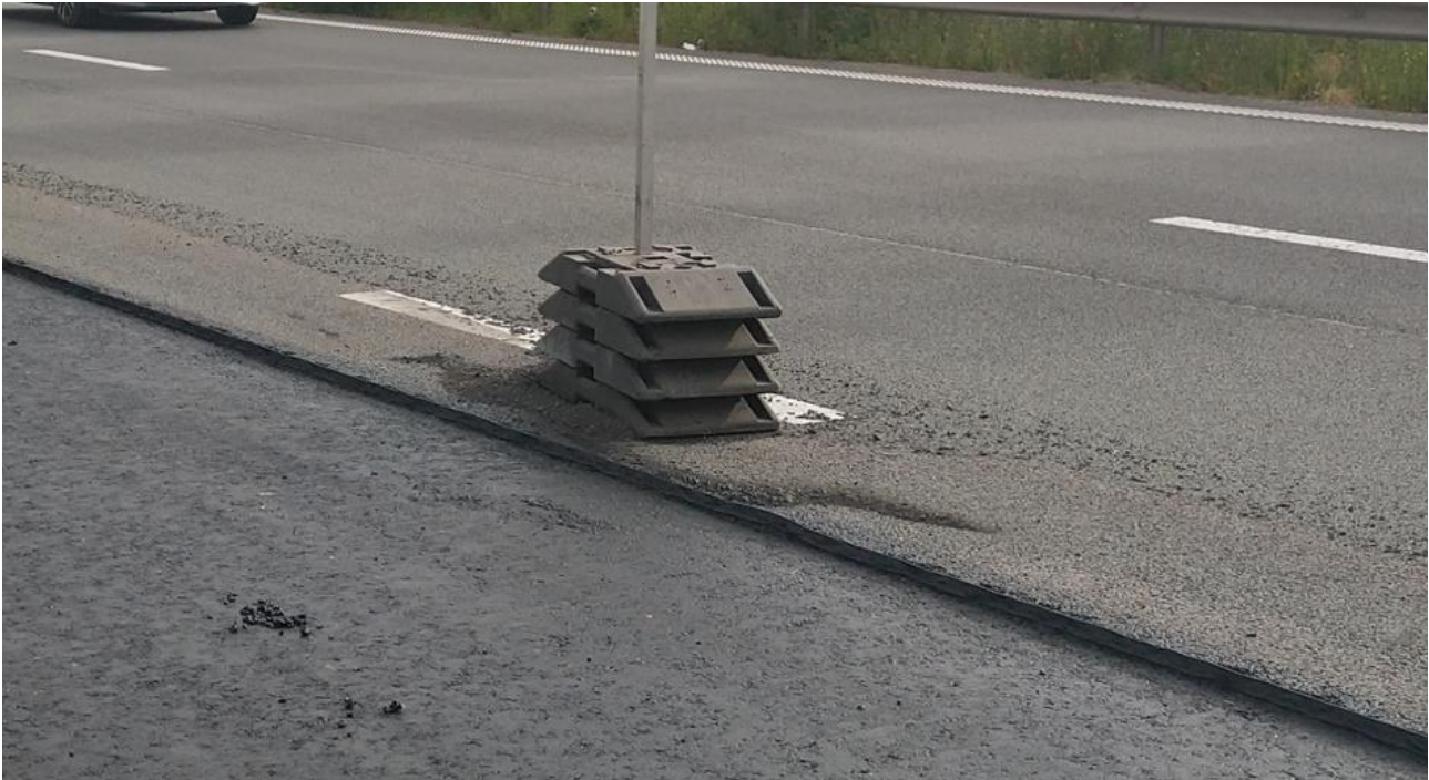
Figuur 6 Puin dat niet opgeveegd kon worden rond een verkeersbord
