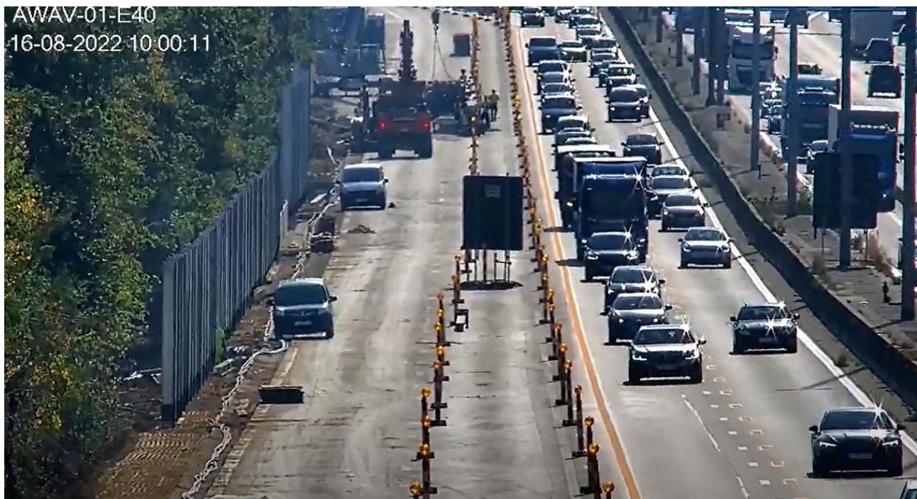
Figuur 24 E40 – werkzaamheden met overtreding veiligheidszone rond materiaalpost
